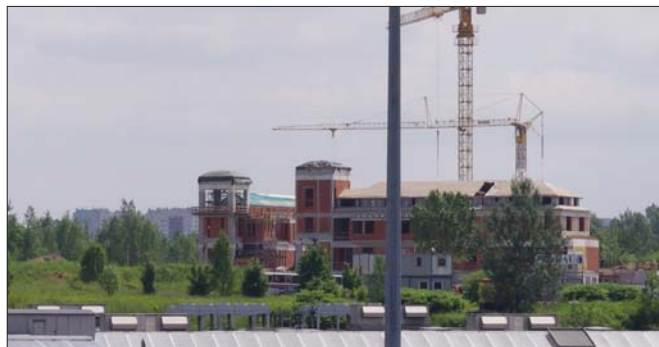
Widok na budowę Centrum Jana Pawła II „Nie lękajcie się” od strony zachodniej, wrzesień 2010 r.
